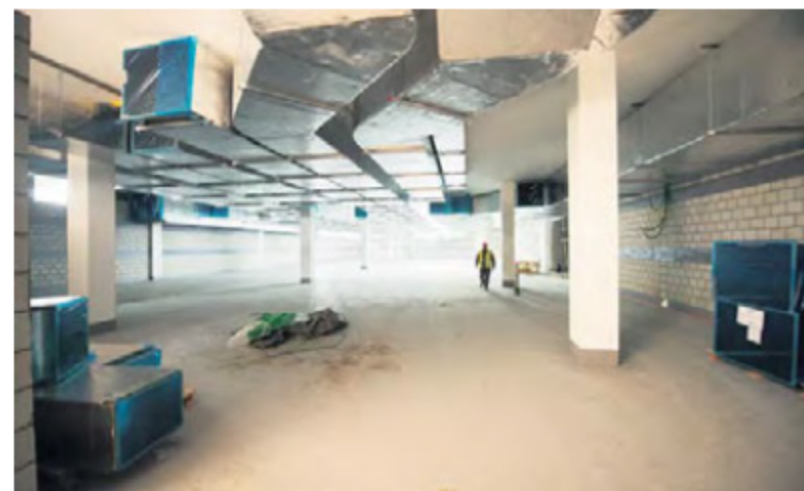
Lüftungskanäle ohne Ende.
